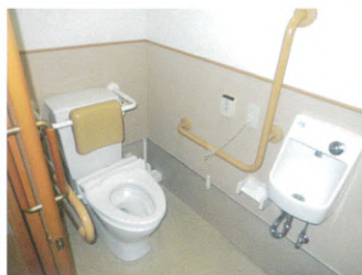
▲ 居室内トイレ
